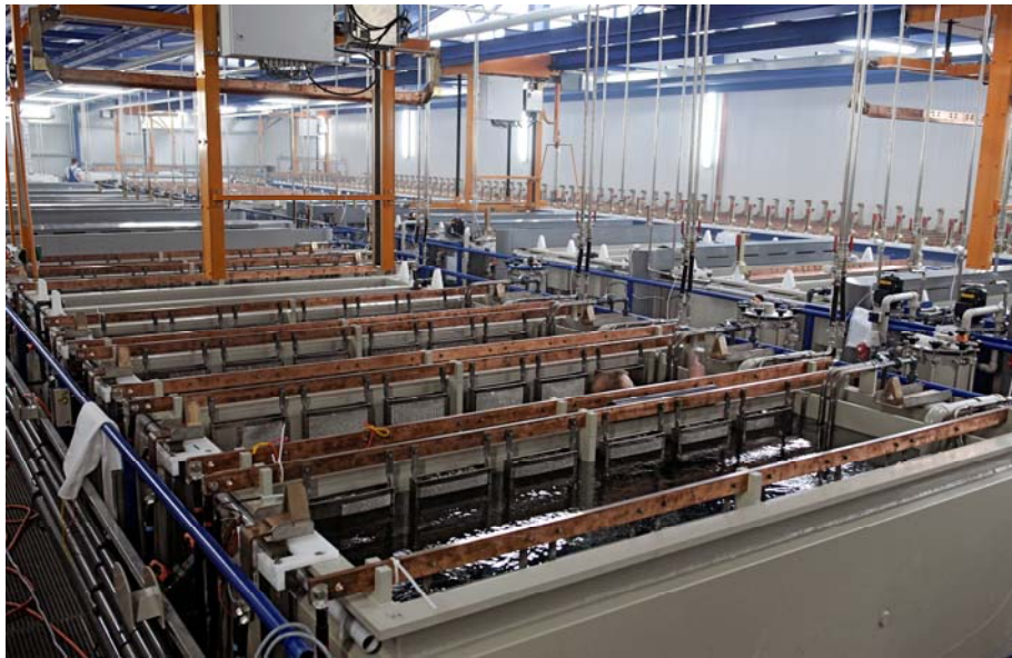
Blick über die Anlage
