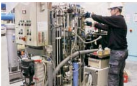
Membrananlage zur Entfettungsbadpflege
