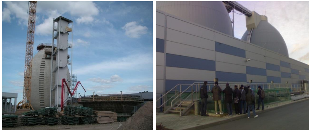
Abbildung 3: Kernstück einer Co-Vergärungsanlage für Klärschlamm mit Bioabfällen (Bildquelle: INTECUS)
